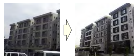
既存の団地改修のうち、断熱性能の向上のための窓枠改修工事
